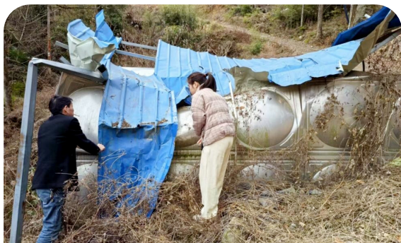
陈柳羽查看村内蓄水池损毁情况
